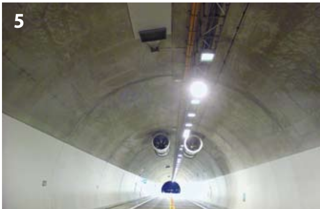
Erste deutsche SLASS-Installation in einem Autobahntunnel im Rahmen des Forschungsprojekts
