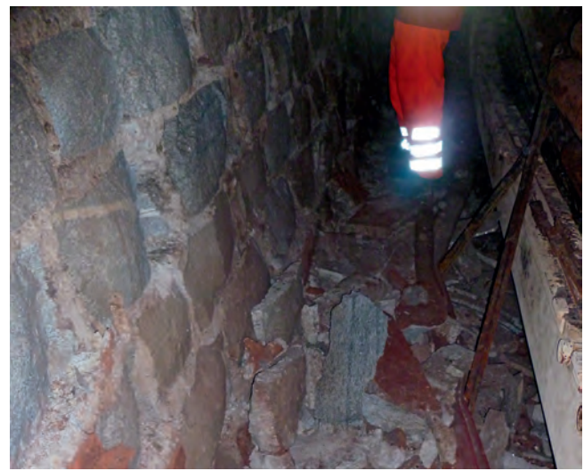
Tunnelwandung nach dem Brand – mit Abplatzungen Tunnel wall after the fire – affected by spalling
