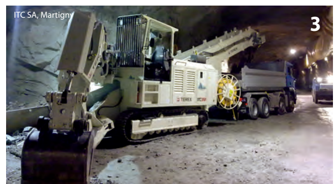
Lademaschine TIC 312-H3 im Erschließungsstollen Loading machine TIC 312-H3 in the exploratory tunnel
