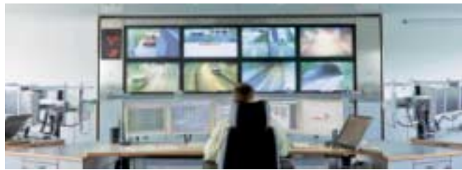
1 Beispiel für Verbesserungen aus jüngster Zeit: Tunnelleitzentrale
