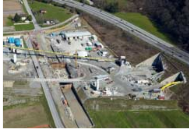
7 Vortrieb beim Ceneri-Nordportal unter der Autobahn 7 Driving beneath the motorway near the Ceneri north portal
