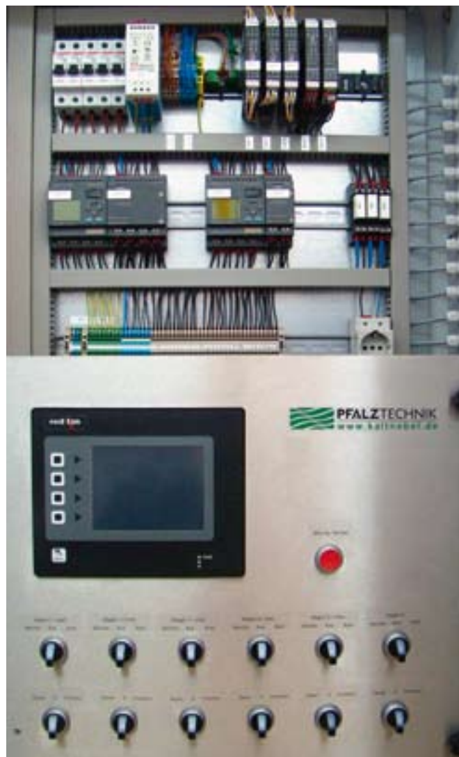
5 Zentralsteuerung mit Datenlogger
