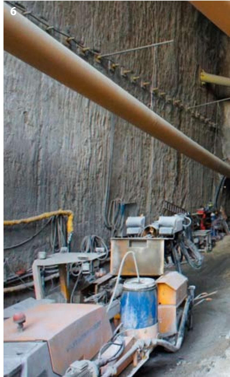
Der Vortrieb im Tunnel A unter dem Malinov Boulevard schreitet voran The drive in Tunnel A below the Malinov Boulevard is progressing
