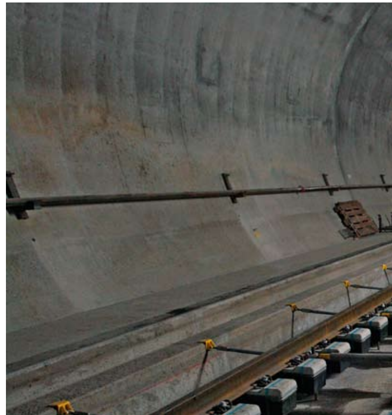
Einbau der Fahrbahn im Gotthard-Basistunnel Installing the track in the Gotthard Base Tunnel
