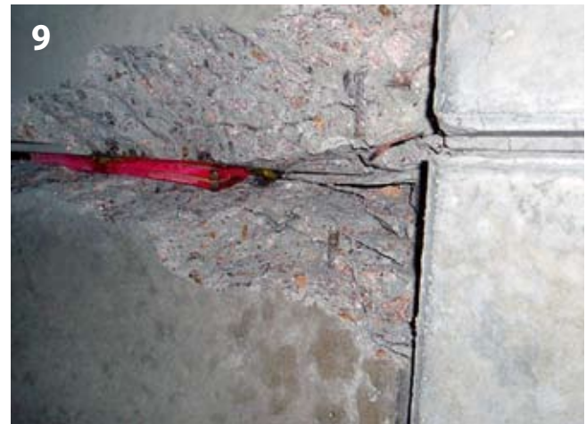
9 Abplatzungen durch Packing Spalling due to packing
