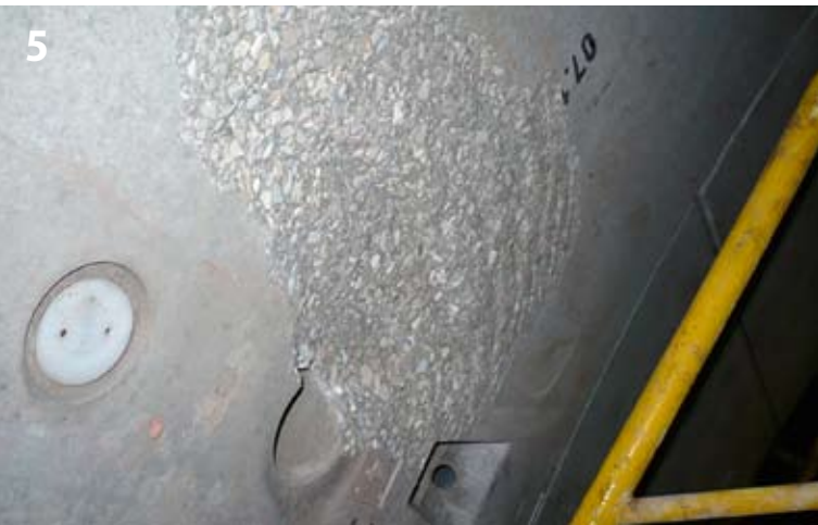
Abplatzung an der Erektorführung
