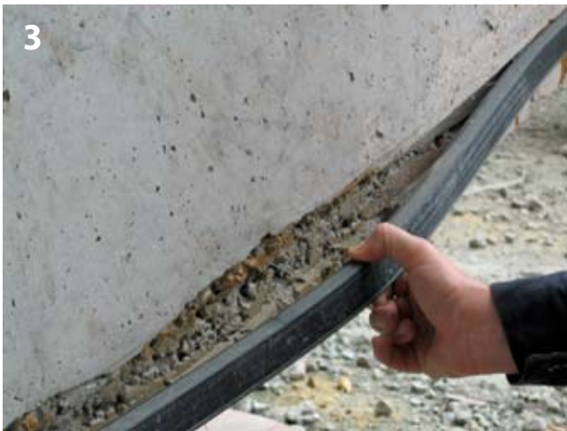
Luftporen im Dichtungsbereich Air pores in sealing area
