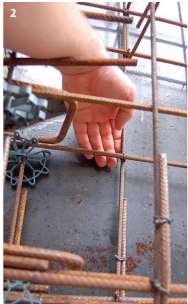
Abgeklappte Abstandhalter in einer Tübbingschalung Folded spacer in a segment formwork
