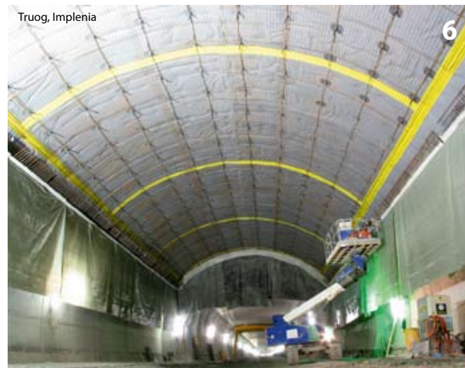
Schutzbahn (grau) mit Abschottelementen (gelb) und mit Ankern fixierte Rückprallreduktion (Gitter)
