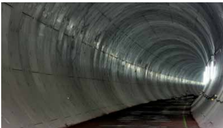
Fertiger Tunnelrohbau NKWT mit Ausgleichsschicht vor Beginn der Arbeiten am Oberbau Completed tunnel roughwork with compensation layer prior to starting on the superstructure
