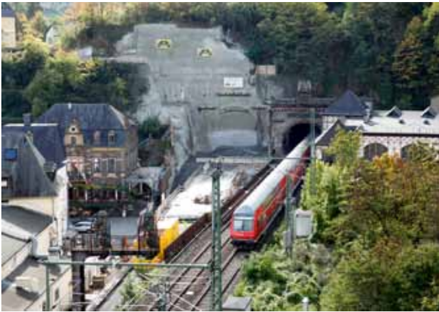
Voreinschnitt Cochem von oben: Tunnelanschlagwand Ausfahrt TVM in unmittelbarer Nähe der Wohnbebauung
