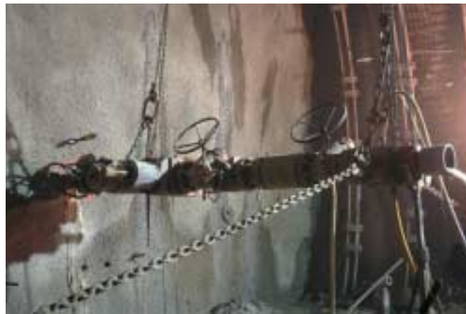
13 Bohreinrichtung in Sedrun mit Standrohr, Preventer und Absperrorgan 13 Drilling unit in Sedrun with standpipe, preventer and shut-off valve
