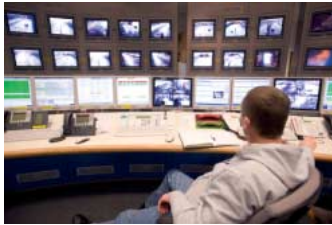
2 Tunnelleitzentrale des Tunnels Flughafen Tegel
